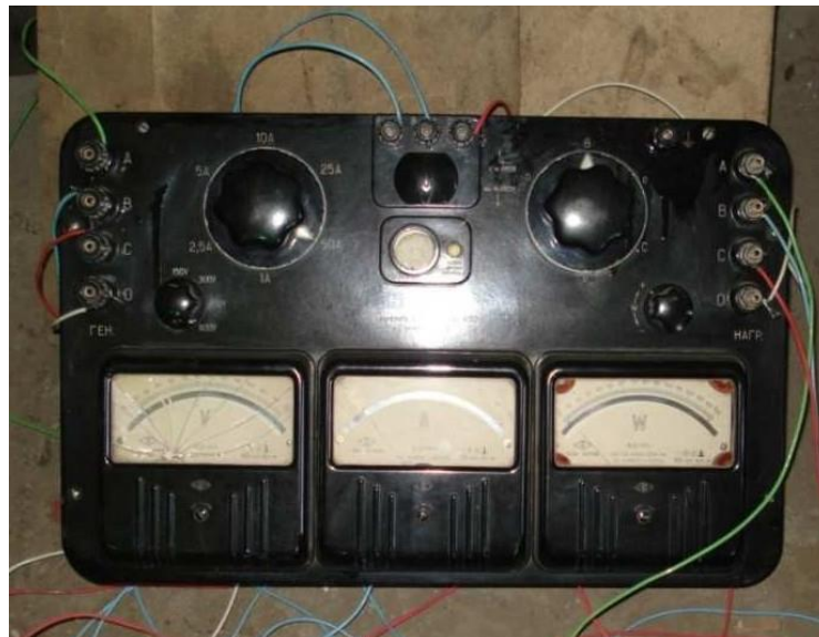
Рис. 4.9 - Контрольно-вимірювальний щиток К-50: розташовані зліва направо: 1 - вольтметр; 2 - амперметр; 3 - ватметр
