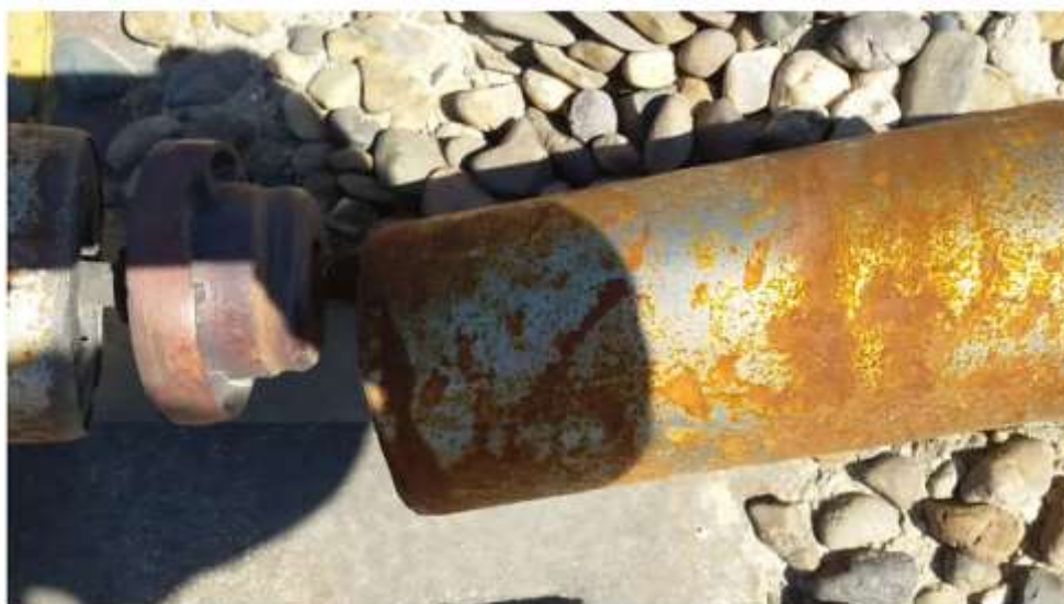
Рис. 1.17 - Заклинювання підшипника конвеєрного ролика з видавлюванням ступиці (стрічковий конвеєр, транспортування гравію)
