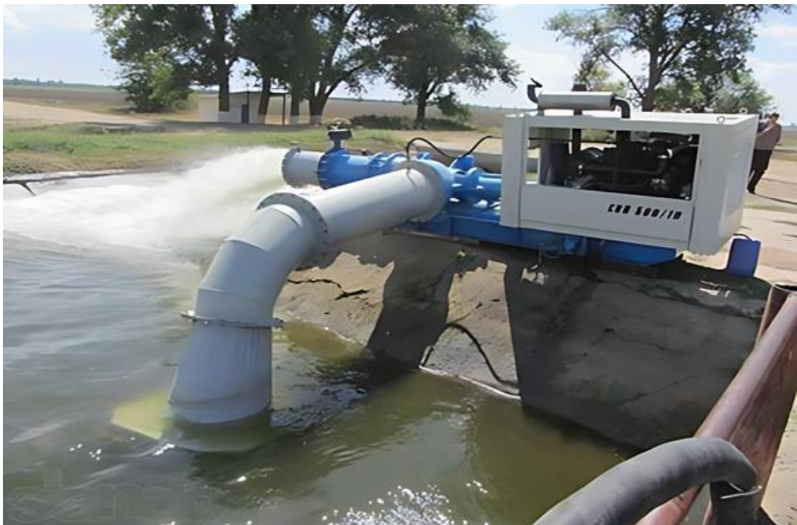
Рис.15.6. Дизельна насосна станція СНП-500/10
