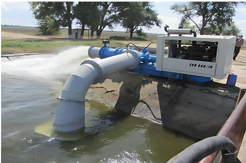
Рис.15.6. Дизельна насосна станція СНП-500/10
